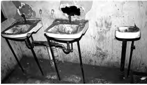
Figura 28. Lavamanos en mal estado en baños de la Planta Peletizadora. Fototeca, N.L. N° Inv. 56571.
