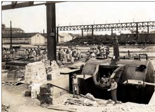
Figura 44. Colocación de ladrillo refractario al Mezclador de 150 Tons. Eugenio Espino Barros. Monterrey, N.L., México. D.R. ©2019 Fototeca Nuevo León – CONARTE, Fondo: Fundidora.
