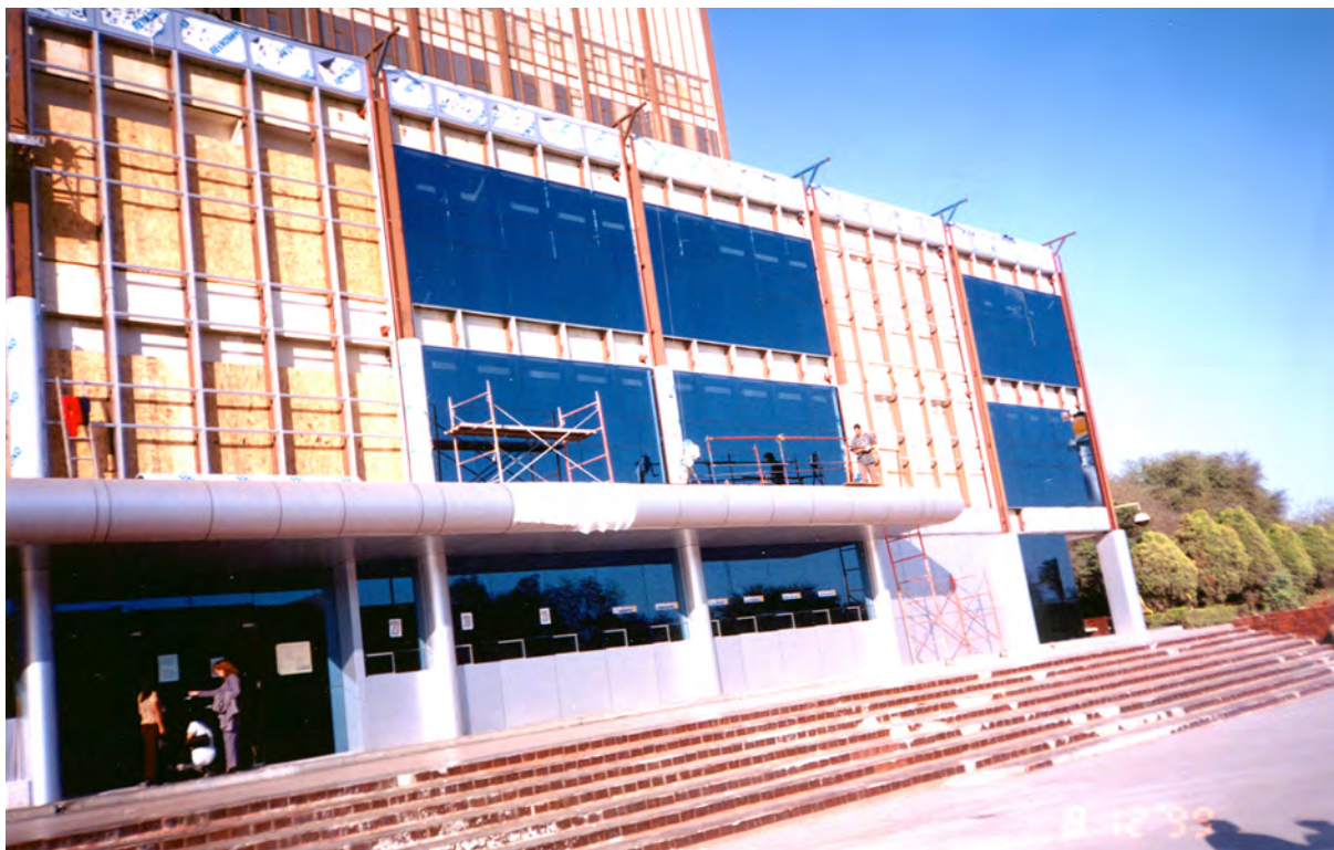
■ Nueva fachada de Rectoría de la UANL terminada en 2001, durante el rectorado de Luis Galán Wong. Fuente. CDyAH-UANL.
